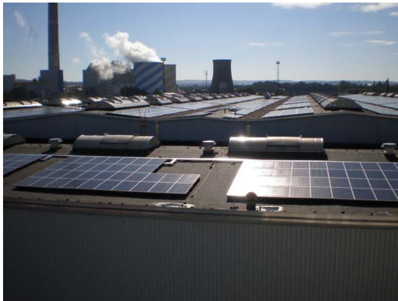
Abbildung 20: 1,1 MW Fotovoltaikanlage auf dem Dach der ASR Fahrzeughalle
